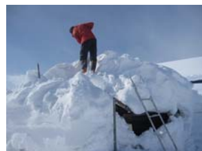
雪に埋もれたポンプ小屋の除雪(2月27日)
