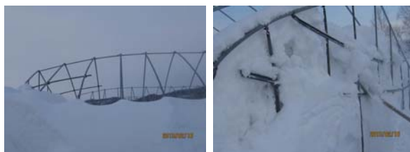
度重なる大雪により、ハウスの一部に被害が発生(2月16日)
