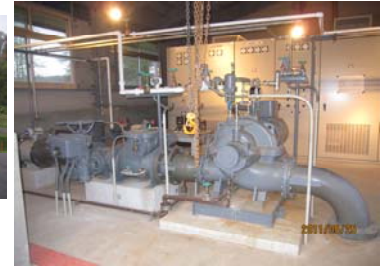
揚水機場に設置された巨大なポンプ
